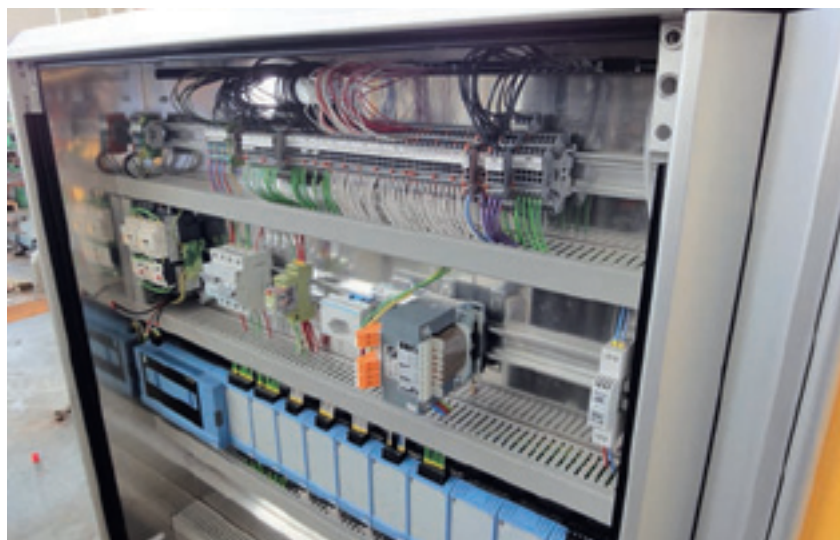
Schaltschrank mit Steuerungstechnologie für die Gebäudetechnik.
