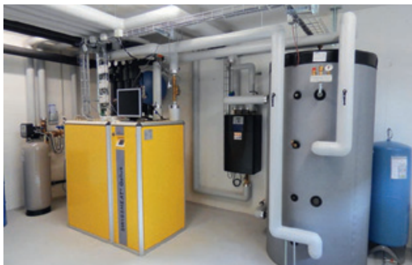
MFH-Heizungsanlage mit Wärmepumpe inkl. Hydraulikmodul, Frischwasserstation, Wärmespeicher und Expansionsgefäß.
