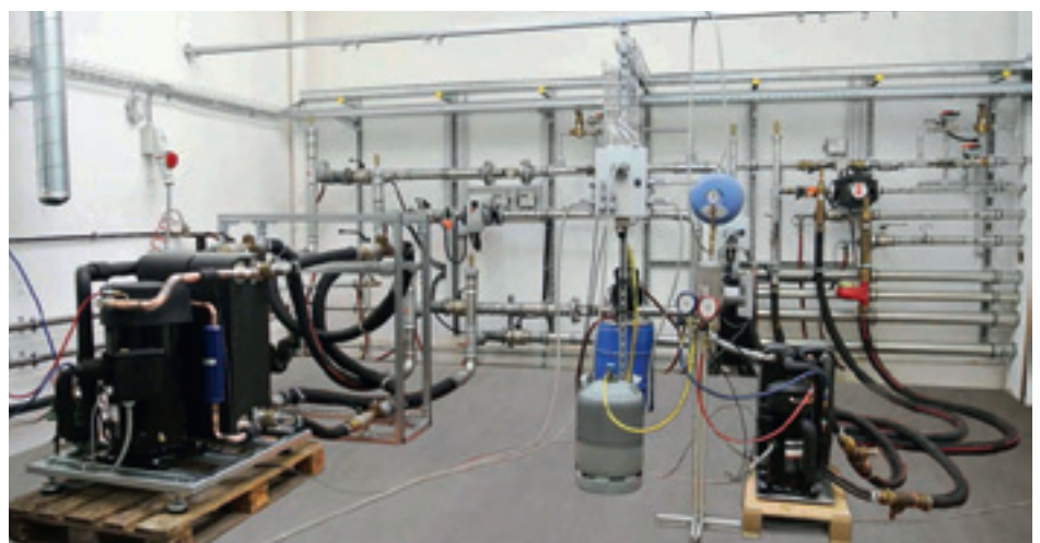
Wärmepumpen-Prüfstand bei der Firma Bion Bauhaus AG.
