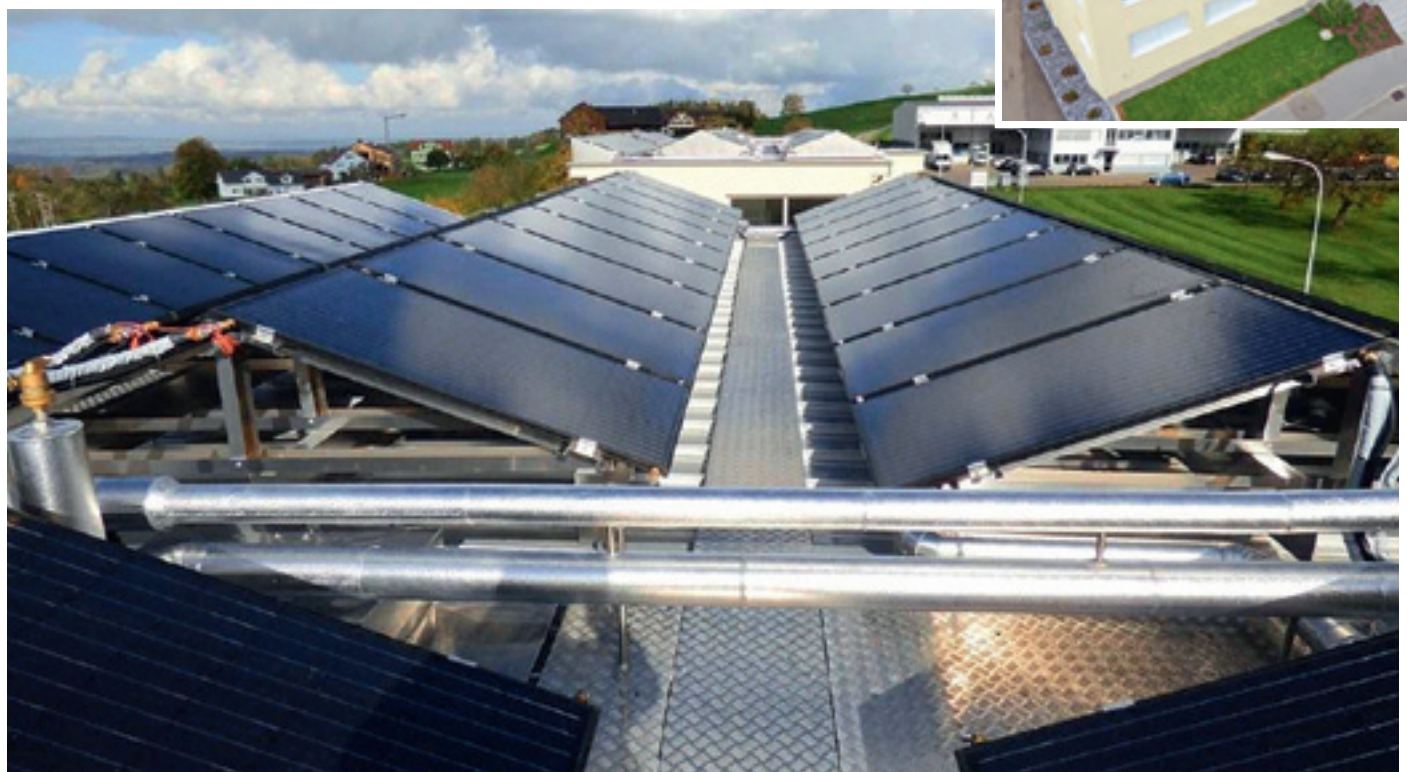
Hybridkollektoren zur gleichzeitigen Strom- und Wärmegewinnung auf einem Mehrfamilienhaus in Andwil SG. (Fotos: Bion Bauhaus AG)
